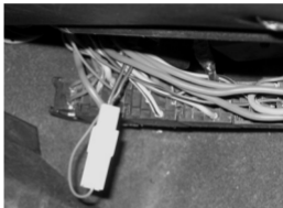
Рис. 16 Подключение управления реле вентилятора
